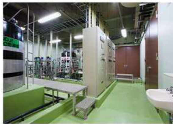
▲ たんこう浄水場内の設備
