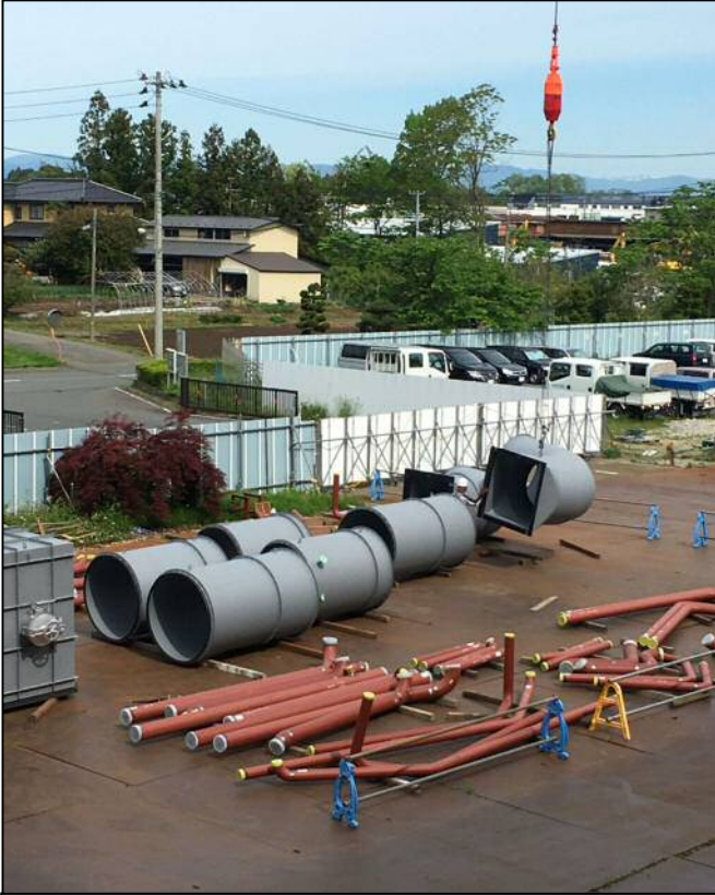
排ガスを処理設備へ通す「ダクト」
